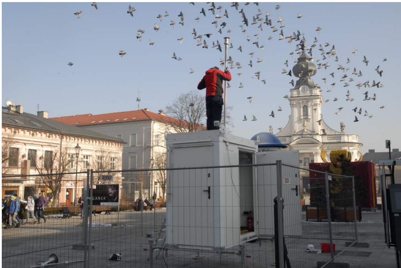
Rysunek 3.2: Zdjęcie stacji w czasie jej instalacji w Wadowicach. [fot. Szymon Lukaj]
