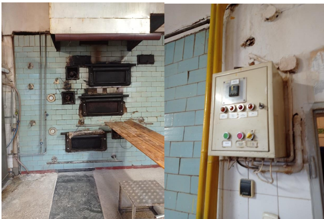
Rysunek 4.35 Piec RRK oraz urządzenia sterownicze. Urządzenie zasilane gazem ziemnym. Źródło: opracowanie własne
