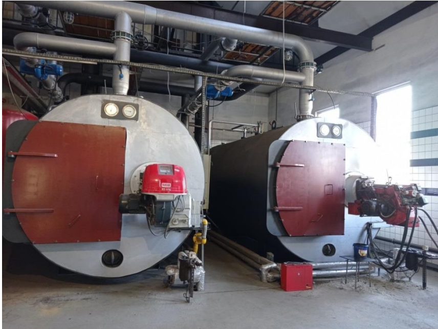
Rysunek 4.18 Kotłownia o dużej mocy zasilana miksem paliw w postaci oleju opałowego i gazu. Uprawa kwiatów ciętych (róże). Źródło: opracowanie własne
