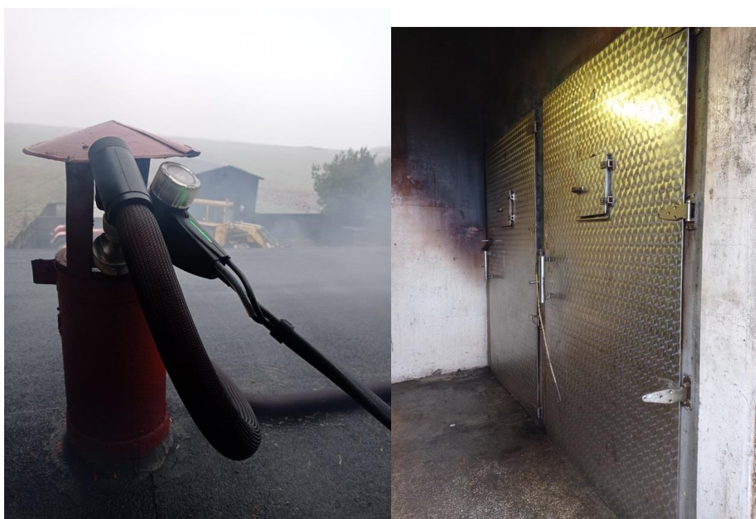
Rysunek 4.69 Po lewej widoczne sondy urządzeń pomiarowych zainstalowane w kominie. Po prawej drzwi komór wędzarniczych. Źródło: opracowanie własne
