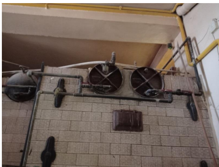
Rysunek 4.36 Widok na zbiorniki ciśnieniowe pary znajdujące się w górnej części pieca. Źródło: opracowanie własne
