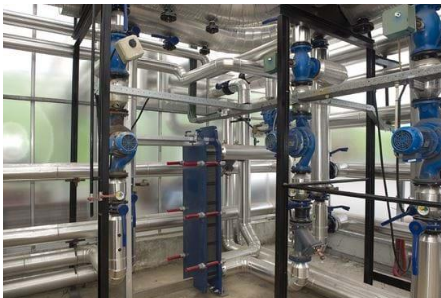
Rysunek 6.15 System hydrauliki obsługujący magazynowanie energii z wykorzystaniem pomp ciepła (źródło: https://www.certhon.com/en/projects/ter-laak )
