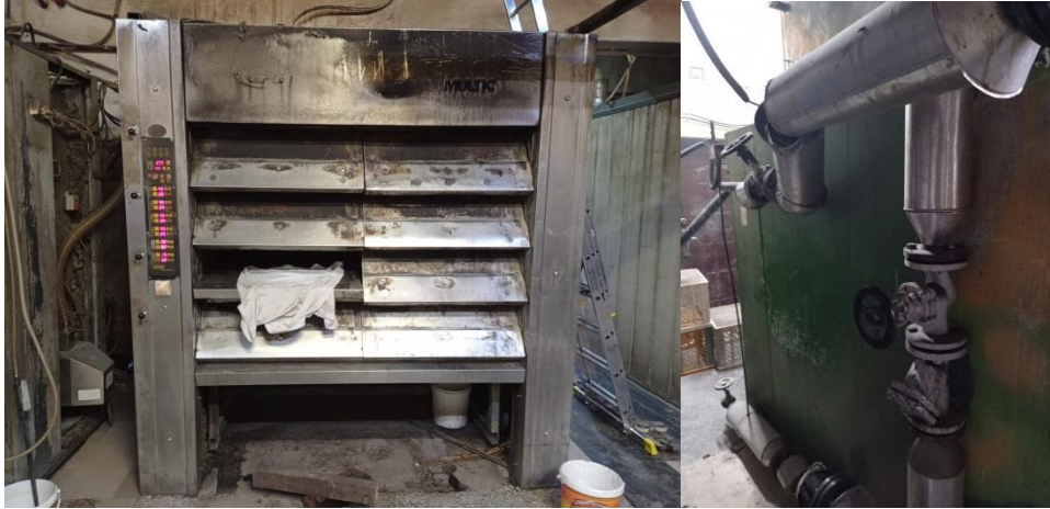
Rysunek 4.42 Po lewej piec zasilany ciepłem z wymiennika pośredniego zamontowanego w kotle z palnikiem pelletowym. Po prawej dystrybucja gorącego oleju z kotła do pieców piekarniczych. Źródło: własne
