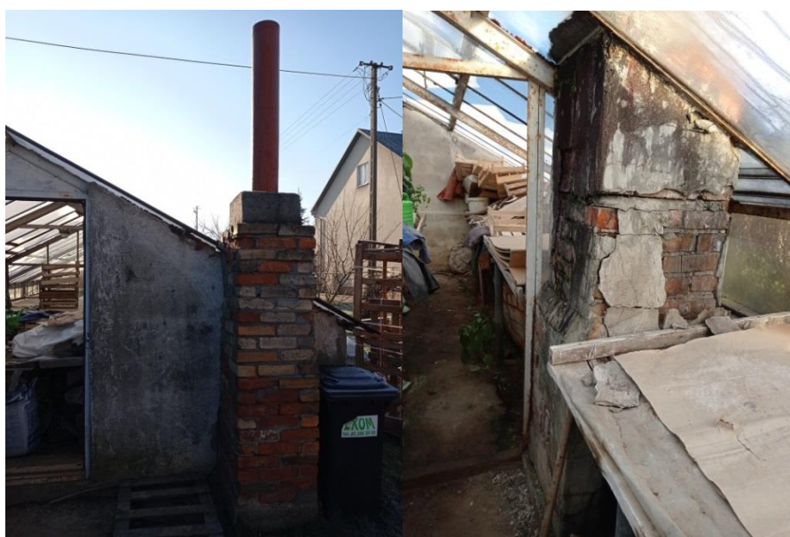
Rysunek 4.15 Widok górnej części akumulacyjnego pieca grzewczego w szklarni. Źródło: opracowanie własne
