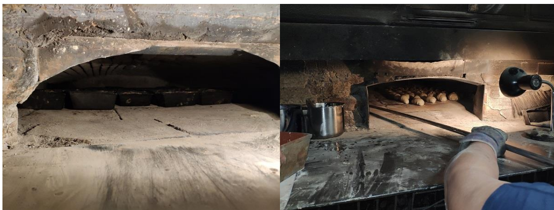
Rysunek 4.40 Widok na komorę wypiekową w trakcie przeprowadzania prac. Źródło: opracowanie własne
