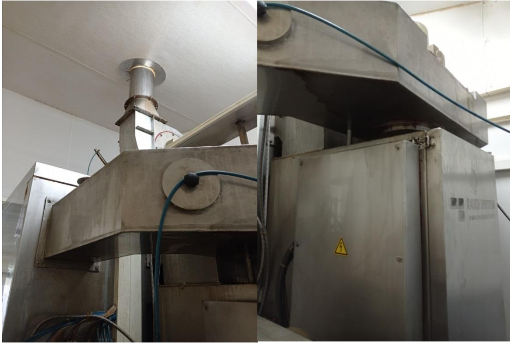
Rysunek 4.64 Elementy wykonawcze komory węzarniczej, po lewej widoczny wentylator wyciągowy. Źródło: opracowanie własne
