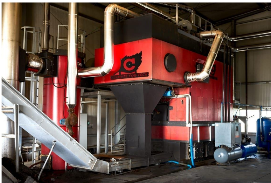
Rysunek 3.12 Kocioł na biomasę znanego producenta (sprawność ok 87%) z układem kondensacji pracujący w gospodarstwie szklarniowym w miejscowości Międzybłocie w Wielkopolsce (źródło: https://www.warzywa.pl/technika/jak-obnizyc-koszty-ogrzewania-upraw-szklarniowych/ )
