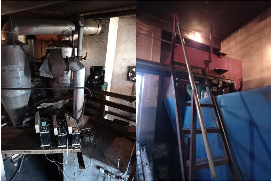
Rysunek 4.28 Widok przekroju pomiarowego za urządzeniem odpylającym (cyklon) oraz lej zasypowy kotła. Źródło: opracowanie własne
