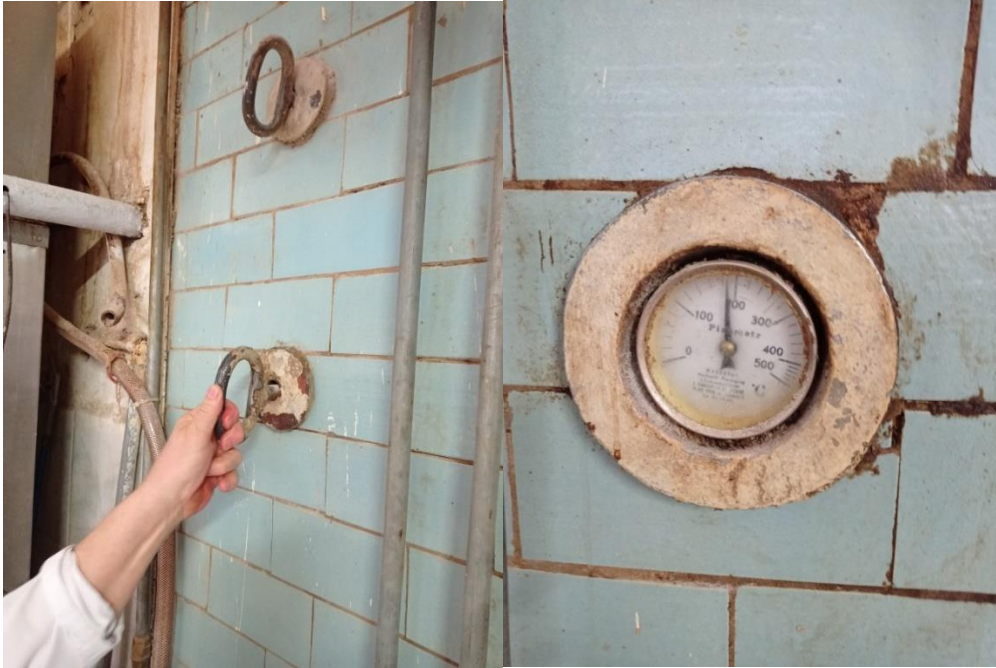
Rysunek 4.37 Układ kontroli pracy paleniska oraz pirometry służące do pomiaru temperatury w komorach wypiekowych. Źródło: opracowanie własne
