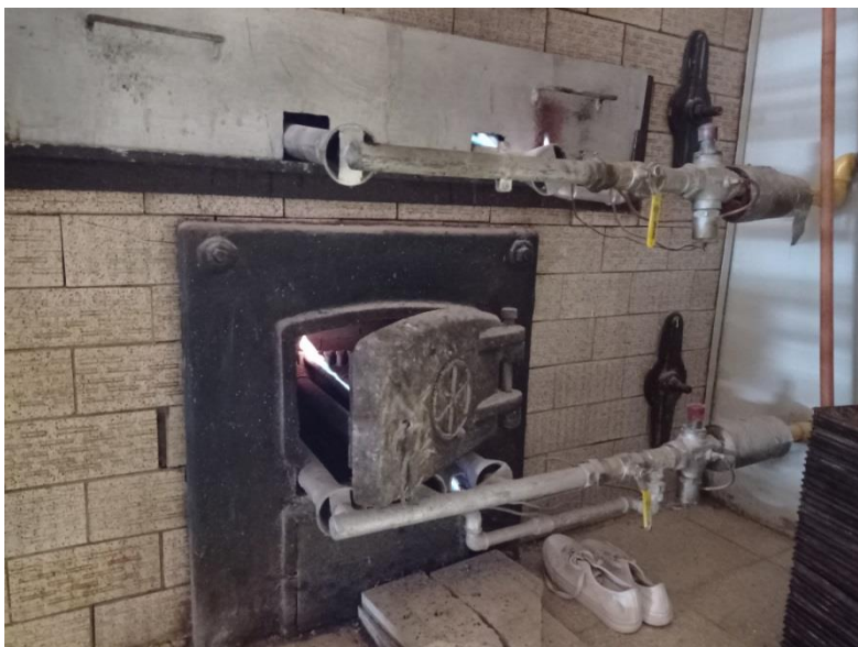
Rysunek 4.38 Widok komory paleniskowej pieca RRK. Widoczne palniki gazowe oraz układy zabezpieczające przed wybuchem (automatyczne zawory odcinające). Źródło: opracowanie własne
