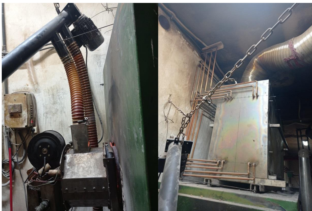
Rysunek 4.41 Po lewej widoczny palnik zasilany pelletem. Po prawej wymiennik odzyskujący ciepło ze spalin. Źródło: opracowanie własne
