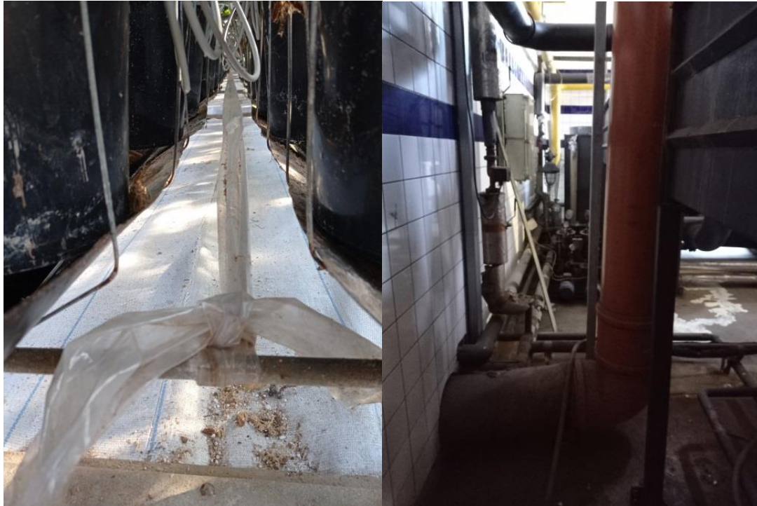
Rysunek 4.21 System dystrybucji zasilania roślin w CO 2 . Po lewej perforowany przewód dozujący wykonany z tworzywa. Po prawej stronie rura doprowadzająca schłodzone i osuszone na wymienniku spaliny z kotła gazowego do instalacji zasilania roślin w CO 2 . Źródło: opracowanie własne
