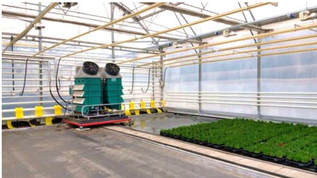
Rysunek 3.13 Nagrzewnica na brykiet lub pellet (moc 70 kW) z rekuperacją i osuszaniem powietrza ( http://www.fcc-innowacje.pl/nagrzewnice-z-rekuperacja-i-osuszaniem-powietrza )
