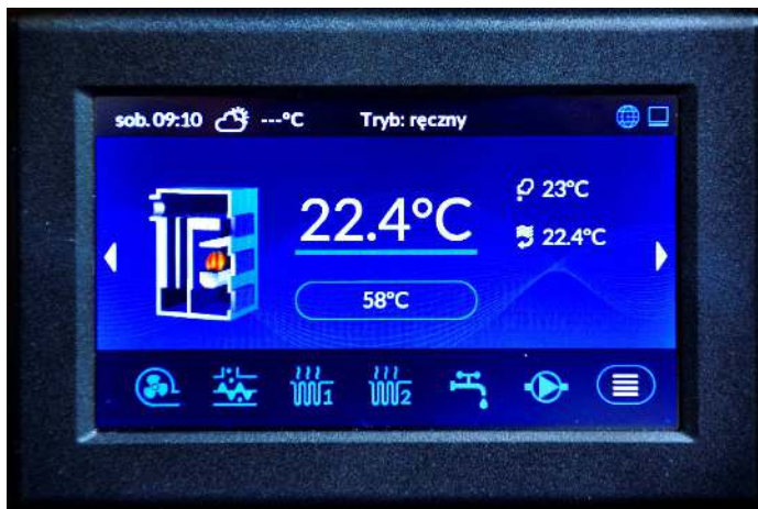
Panel operatorski sterownika
