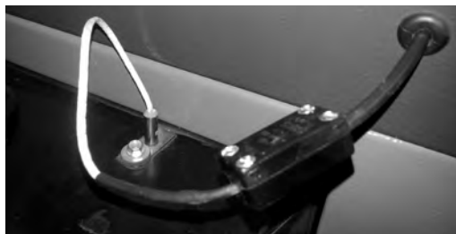
Rysunek 4 Czujnik temperatury spalin zamontowany w czopuch
