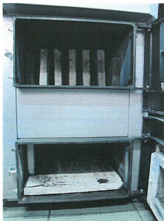
Fot. nr 2. Komora spalania
