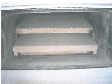
wymienne poziome płyty ceramiczne w górnej części komory spalania
