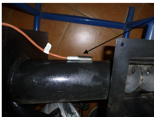
Rys. Czujnik zabezpieczenia kosza zasypowego
