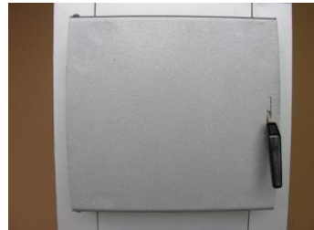
Fot.12. Widok drzwiczek przestawionych.
