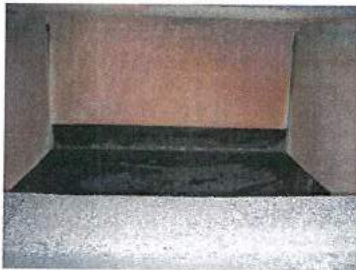
Płyty ceramiczne w środkowej części komory spalania
