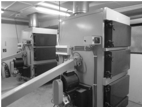
Kotłownia 2x350kW w szkole gastronomicznej
