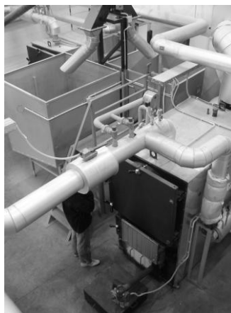
Kotłownia osiedlowa 2x350 kW
