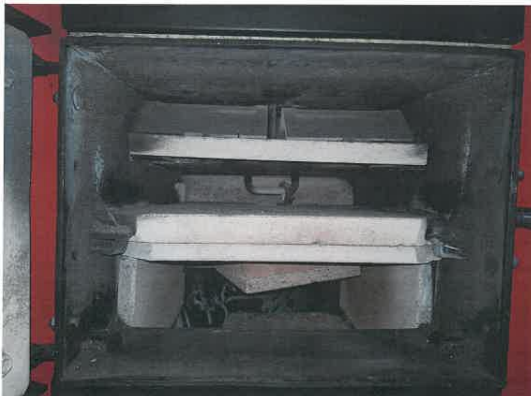
Rysunek 8 Komora spalania wraz z elementami ceramicznymi, dolna część wymiennika oraz zawirowywacze
